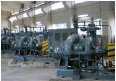
穴生浄水場 インバータポンプ
