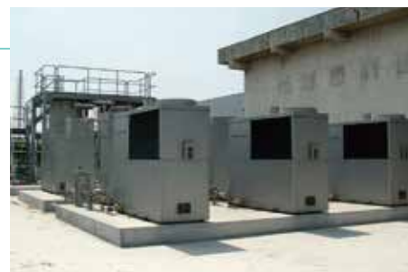
バイオガス発電
