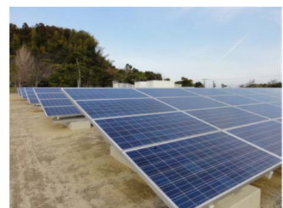
▲大原メガソーラー発電所
