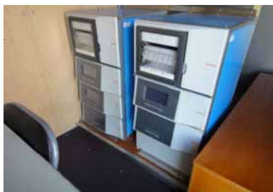
< 自動計測器（大気測定車内） >
