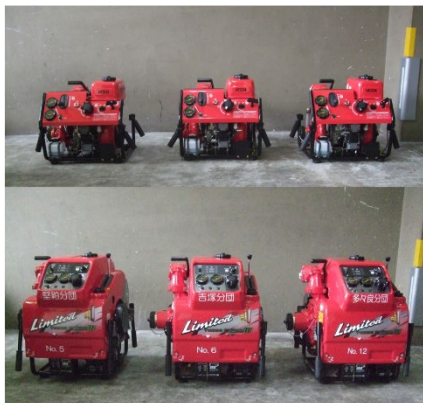
消火活動用小型動力ポンプ
