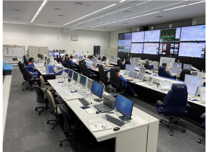
福岡都市圏消防共同指令センター
