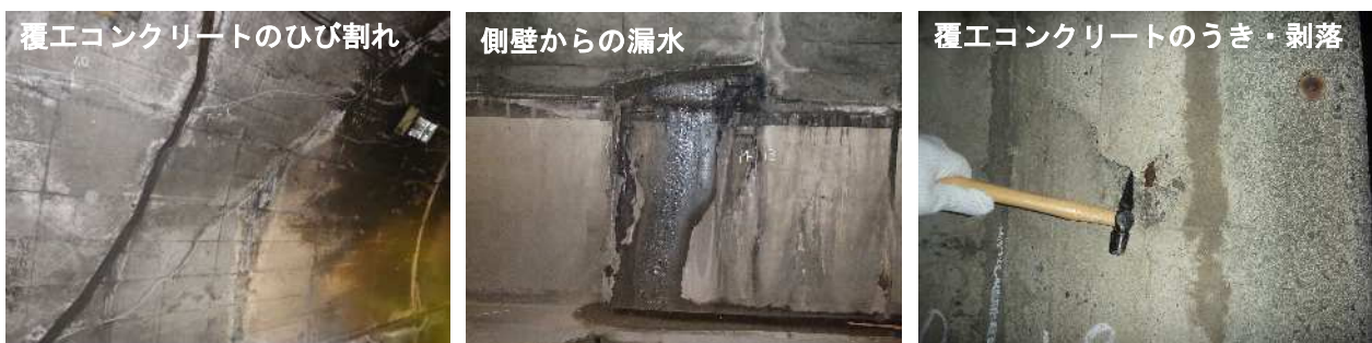
図 1-8 トンネル本体工の損傷事例
