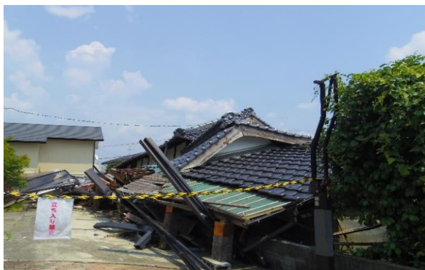
熊本地震による被害状況
