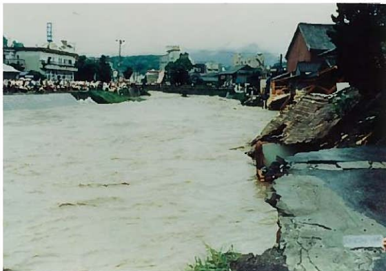
写真 1-5 肝属川 18k200*付近 (朝日橋上流左岸)被害状況
