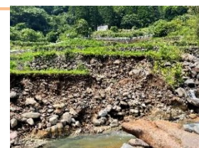
⑦農地の法面崩壊(球磨村)
