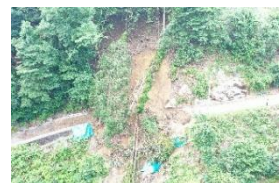
⑧林道の法面崩壊(球磨村)
