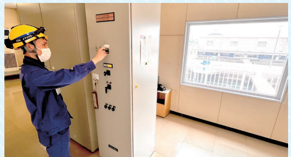
異常や故障が見つかったらすぐに設備の状態を確認しに現場へ
