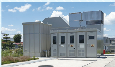
設置された非常用発電設備
