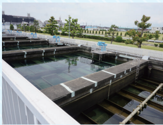
大治浄水場のろ過設備
