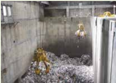
富田工場のごみピット
