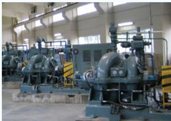
穴生浄水場 インバータポンプ
