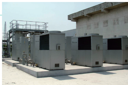
バイオガス発電
