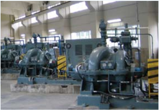
穴生浄水場 インバータポンプ
