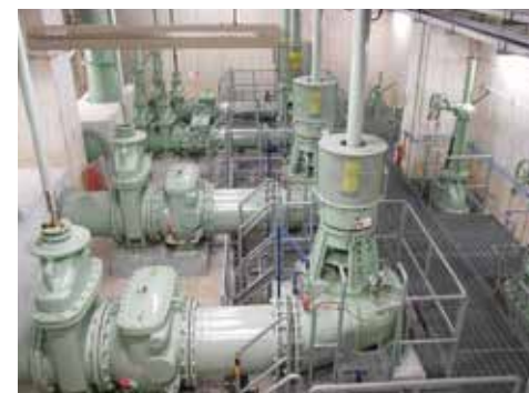
②ポンプ場 (戸畑ポンプ場)
