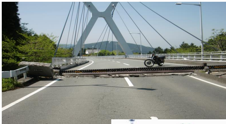
桑鶴大橋の被害状況
