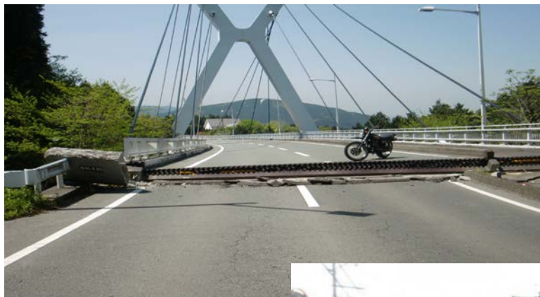
桑鶴大橋の被害状況
