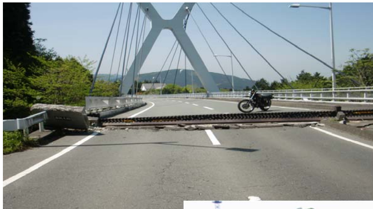
桑鶴大橋の被害状況
