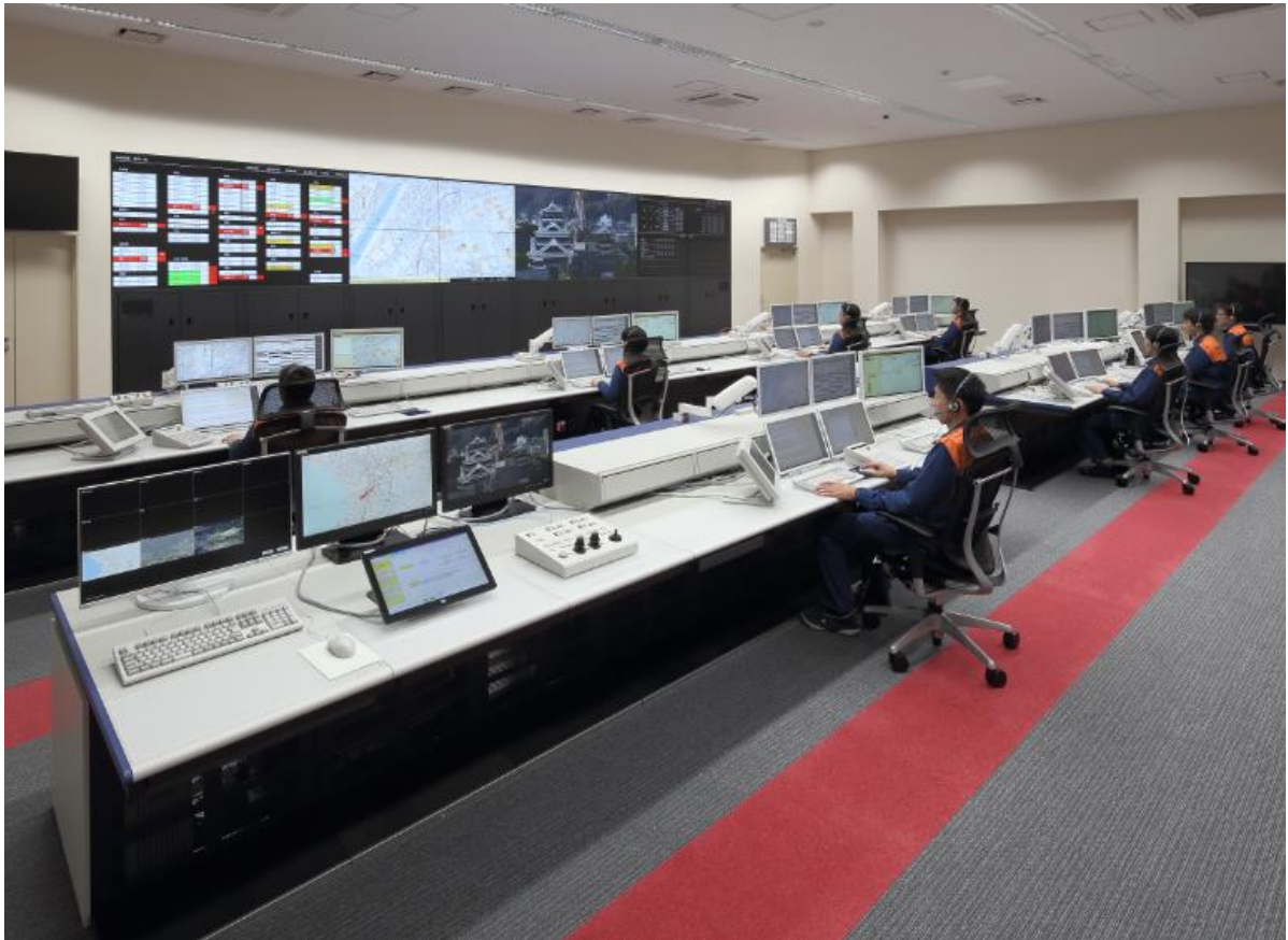
全面更新された指令管制室
