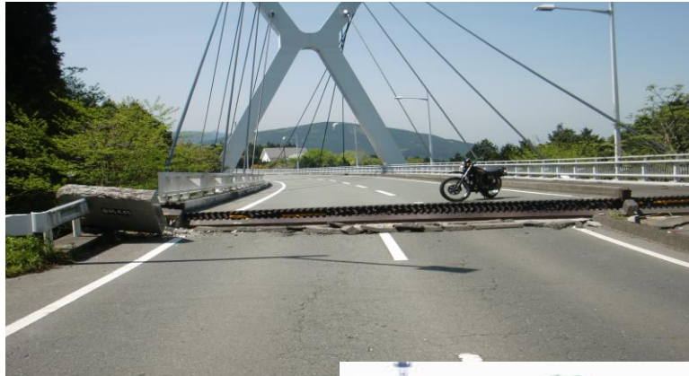
桑鶴大橋の被害状況
