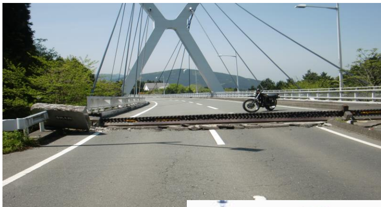
桑鶴大橋の被害状況
