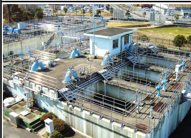
ロクハ浄水場新館 急速ろ過池と薬品沈殿池
