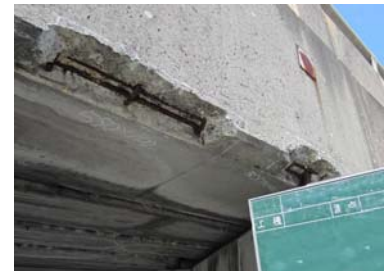
跨道橋のコンクリート剥離
