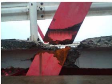
トラス橋の弦材破断
