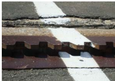
伸縮装置の過大な段差例
