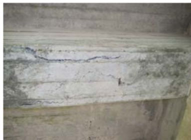
健全度 48 のコンクリート部材 (323 号 第 2 山留橋)
