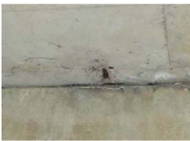
健全度 59 のコンクリート部材 (多久若木線 橋見橋)
