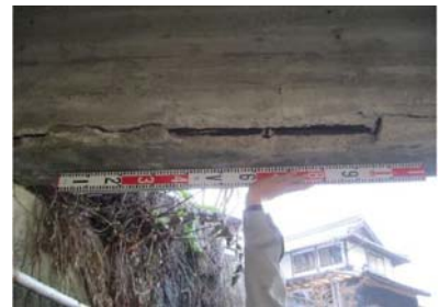
健全度 28 のコンクリート部材 (相知唐津浜玉線 瀬山橋)
