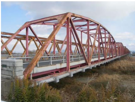
対策前：主構の防食機能の劣化
