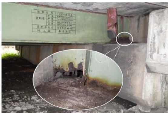
対策前：支承の腐食
