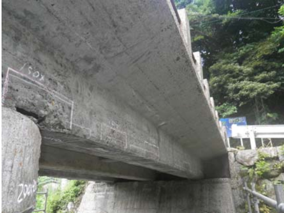
対策前：主構の鉄筋剥離・露出
