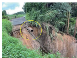
パイプラインの破断
