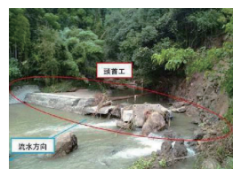
頭首工の被害
