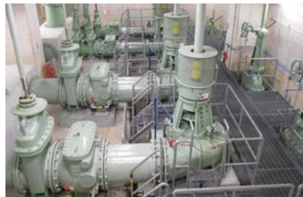
②ポンプ場(戸畑ポンプ場)
